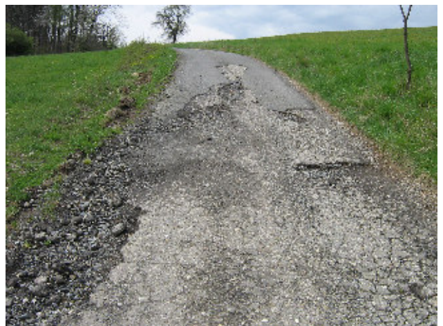
Cesta na dolní paseky před opravou...
